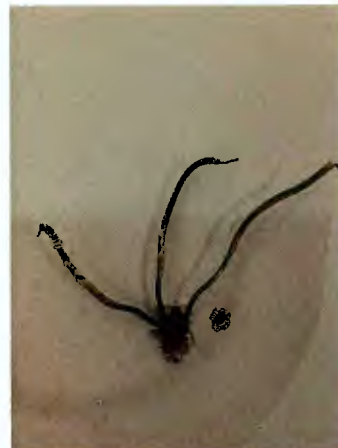
B.7.3 b) : L'isolant d'au moins un conducteur est dégradé.
