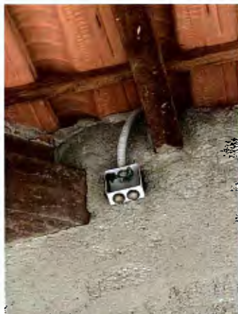
B.7.3 d) : L'installation électrique comporte au moins une connexion avec une partie active nue sous tension accessible.
