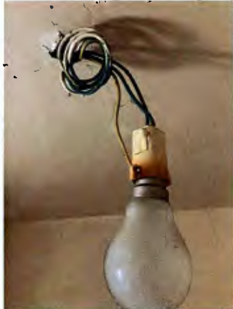
B.4.3 h) : Des conducteurs ou des appareillages présentent des traces d'échauffement.
